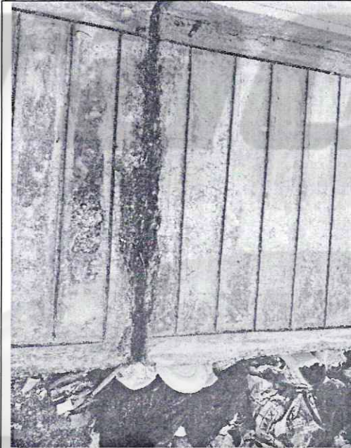
Imagen n° 13: Rampa de concreto sin relleno en junta y presencia de basura.
