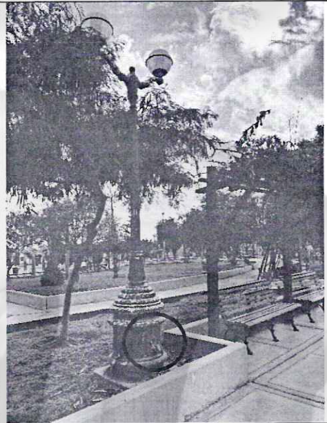
Imagen n° 82: Cables expuestos en poste de luz sin tapa de registro, despintado y jardinera despintada.
