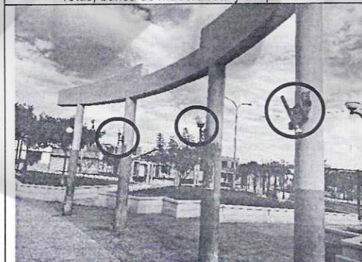
Imagen n° 119: Arcos de concreto despintados con farolas y luminarias rotas.
