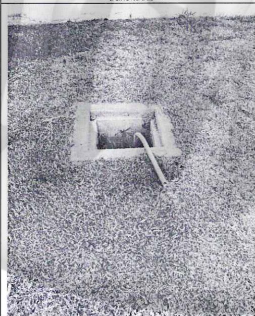
Imagen n° 149: Caja de concreto de agua sin tapa.
