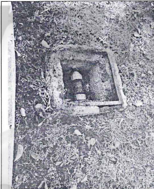
Imagen n° 25: Caja de concreto de agua en mal estado y sin tapa.
