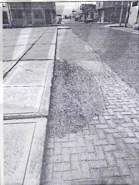
Imagen n° 94: Presencia de material de desmonte en berma.
