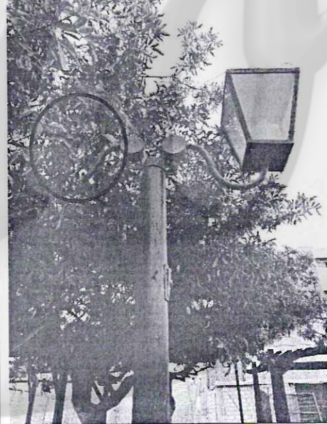
Imagen n° 68: Poste de luz sin farola y sin luminaria.
