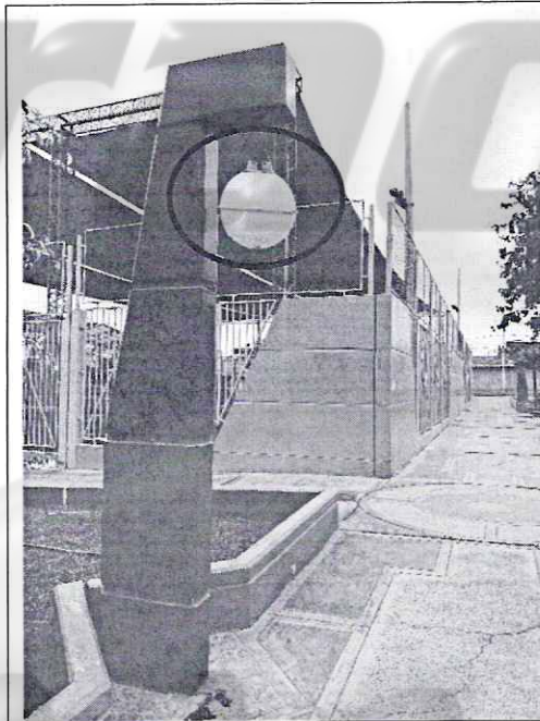
Imagen n° 5: Poste de concreto con farola rota y luminaria rota.
