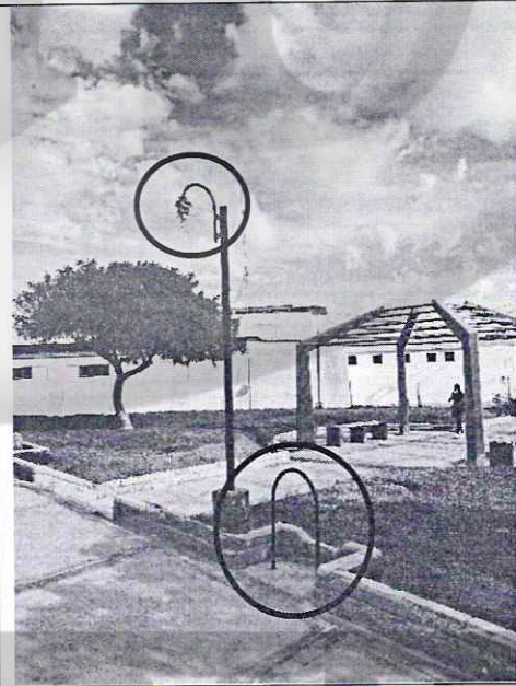
Imagen n° 104: Poste de luz sin farola y luminaria rota, sin tacho de basura y jardineras en mal estado y despintadas.
