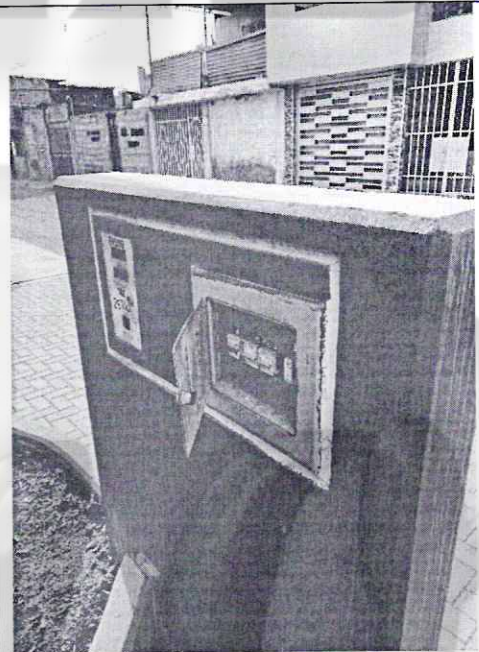
Imagen n° 132: Tablero de distribución de energía abierto.
