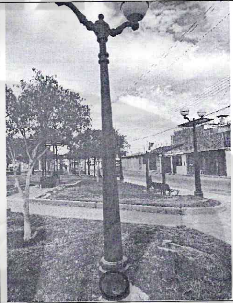
Imagen n° 110: Poste de luz sin tapa de registro.
