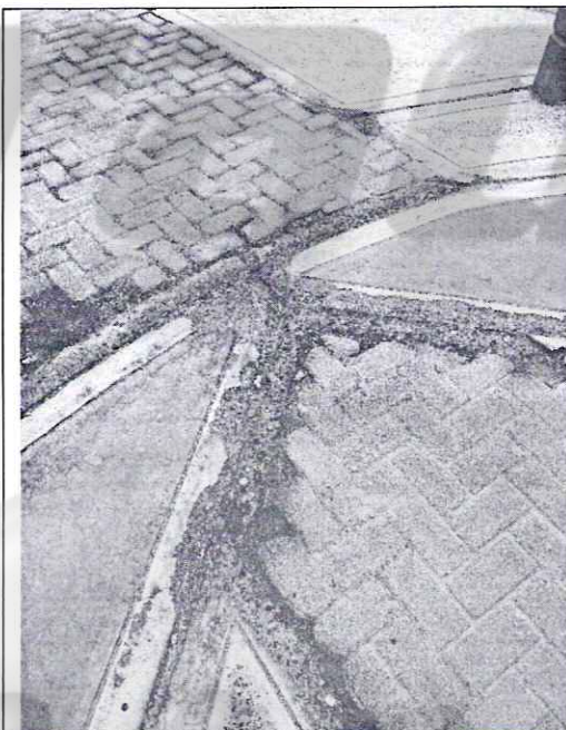
Imagen n° 1: Adoquines y juntas en mal estado.
