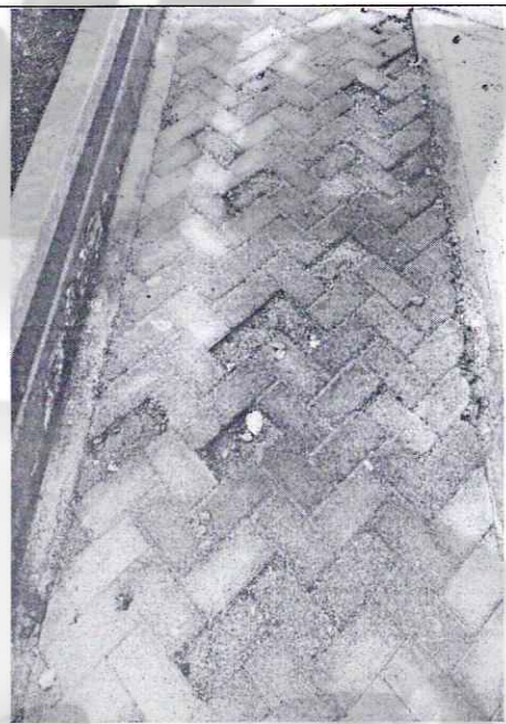
Imagen n° 2: Adoquines y juntas en mal estado.
