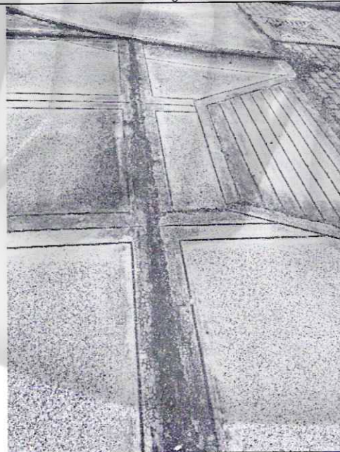
Imagen n° 79: Piso de concreto con juntas sin relleno.
