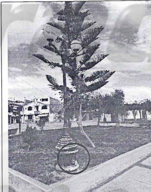
Imagen n° 85: Cables expuestos en poste de luz sin tapa de registro, despintado y jardinera despintada.
