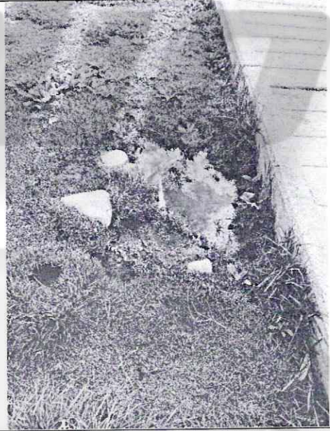
Imagen n° 102: No existe caja de agua.
