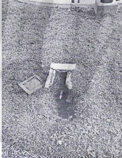
Imagen n° 75: Caja de concreto de agua en mal estado y sin tapa.
