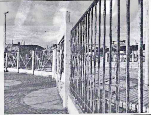
Imagen n° 140: Cerco perimétrico metálico despintado con presencia de oxido.
