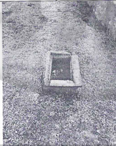
Imagen n° 111: Caja de concreto de agua en mal estado y sin tapa.
