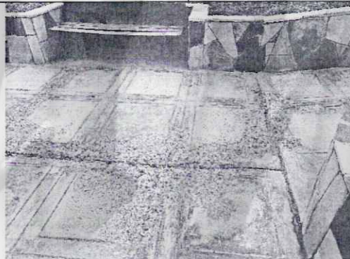
Imagen n° 27: Piso de concreto en mal estado y sin relleno en junta.
