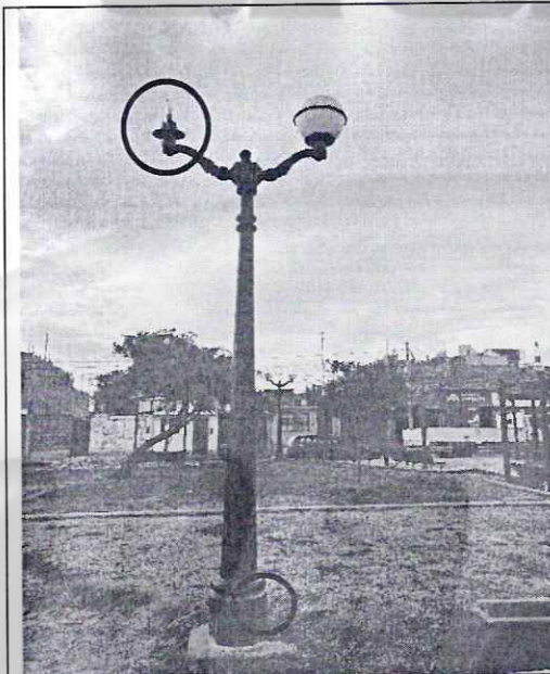
Imagen n° 109: Poste de luz sin farola y sin tapa de registro.
