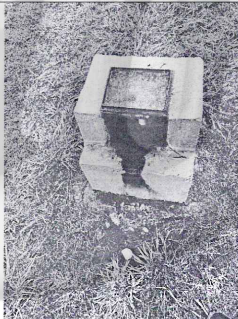
Imagen n° 16: Caja de concreto de agua rota y tapa metálica en mal estado.
