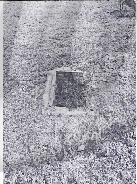
Imagen n° 92: Caja de concreto de agua sin tapa.
