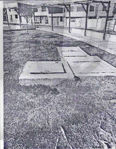
Imagen n° 124: Caja de válvulas sin candado.
