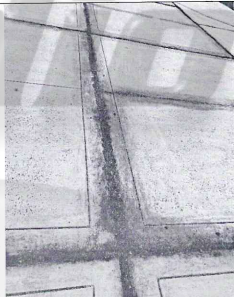
Imagen n° 54: Pisos de concreto con juntas sin relleno.
