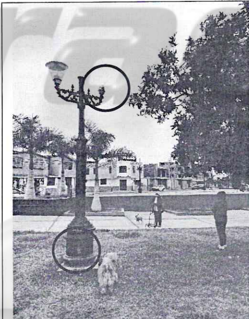
Imagen n° 45: Poste de luz sin farola, luminaria rota con cables de energía expuestos y sin tapa de registro.
