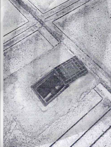
Imagen n° 76: Caja de medidor de agua con tapa rota.
