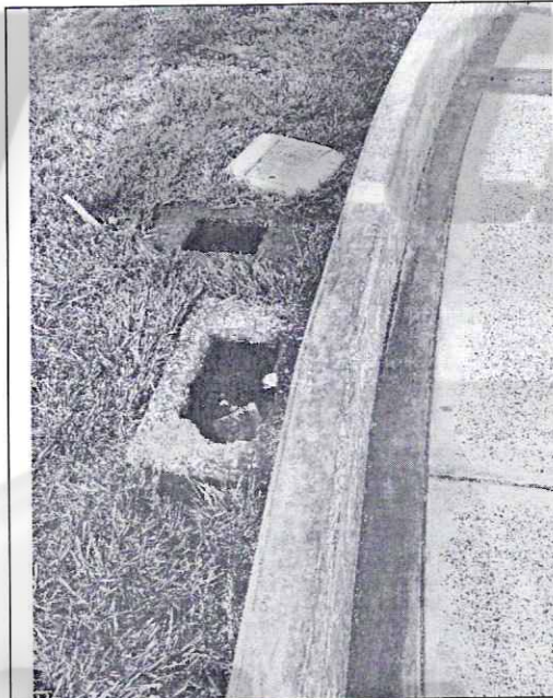
Imagen n° 93: Cajas de concreto de agua en mal estado y sin tapa.
