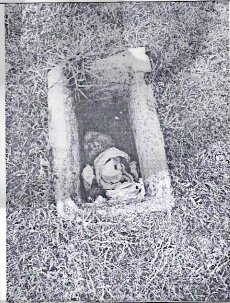
Imagen n° 112: Caja de concreto de agua en mal estado y sin tapa.
