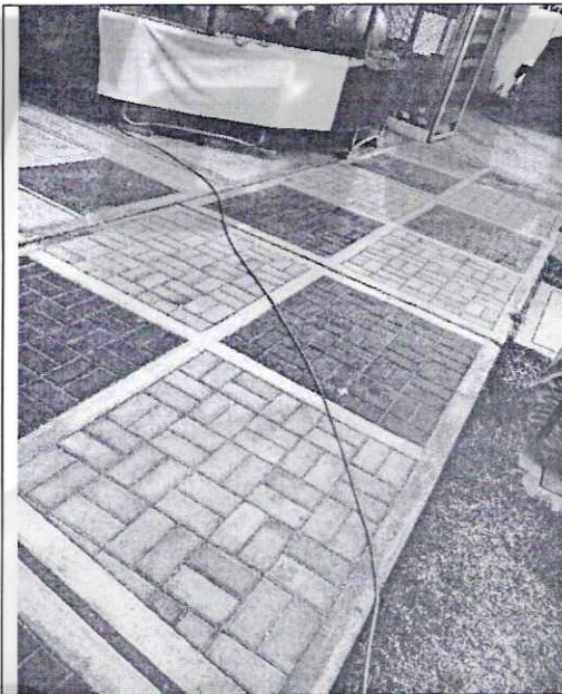
Imagen n° 147: Cable de energía pasa por vereda transitada.
