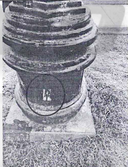
Imagen n° 46: Poste de luz con cables de energía expuestos y sin tapa de registro.
