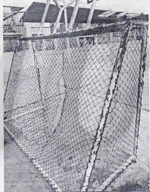
Imagen n° 142: Tableros de básquet y arcos de futbol con presencia de oxido con malla rota.
