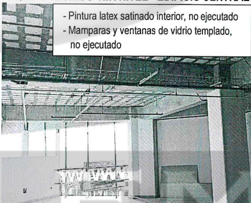
FOTOGRAFÍA N° 6 EQUIPO TÉCNICO 1ER NIVEL - EDIFICIO CENTRAL
