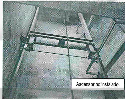
ASCENSOR EN SOTANO DE EDIFICIO CENTRAL
