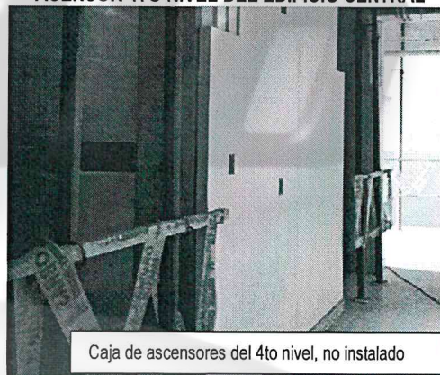
FOTOGRAFÍA N° 24 ASCENSOR 4TO NIVEL DEL EDIFICIO CENTRAL
