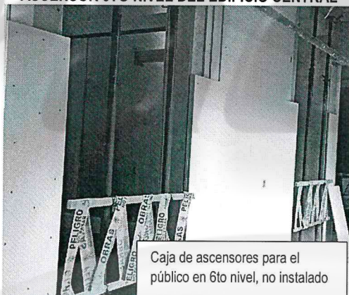
FOTOGRAFÍA N° 23 ASCENSOR 6TO NIVEL DEL EDIFICIO CENTRAL
