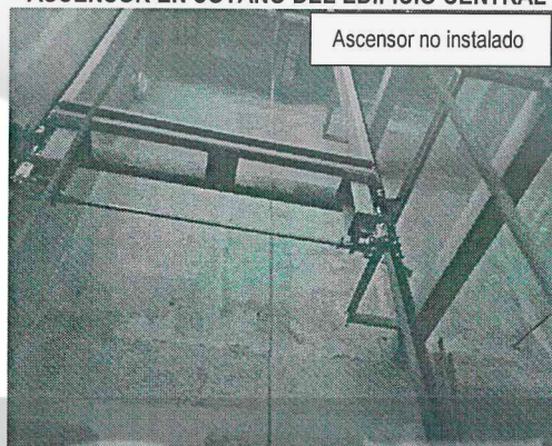
ASCENSOR EN SOTANO DEL EDIFICIO CENTRAL
