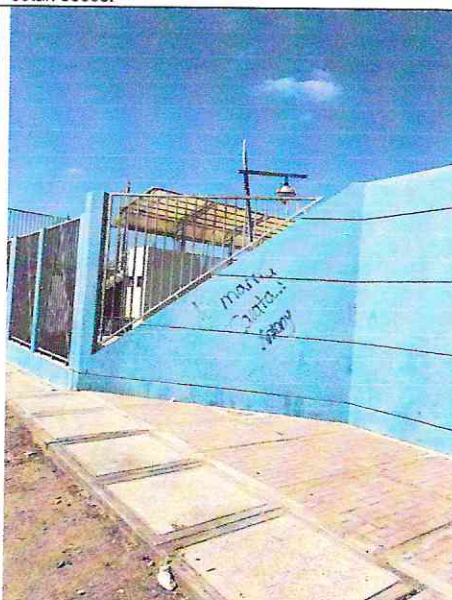
Imagen n° 12: Muros del Campo recreativo con pintas (grafiti).
