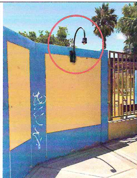
Imagen n° 107: Muros del cerco perimétrico sin luminarias y pintas en muro (grafiti).
