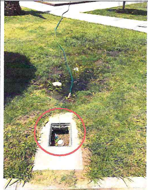
Imagen n° 166: Caja de concreto de medidor de agua sin tapa.
