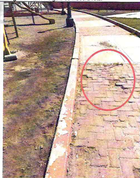
Imagen n° 123: Adoquines de concreto coloreados de caminarias rotos y desgastados.
