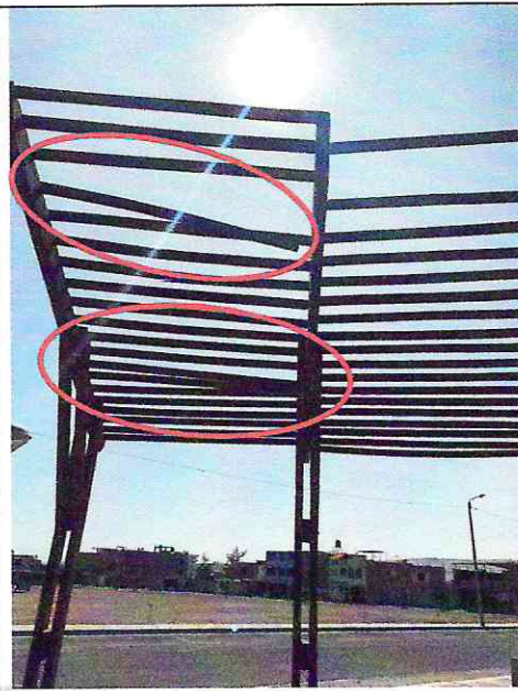
Imagen n° 52: Pérgola de madera rota.
