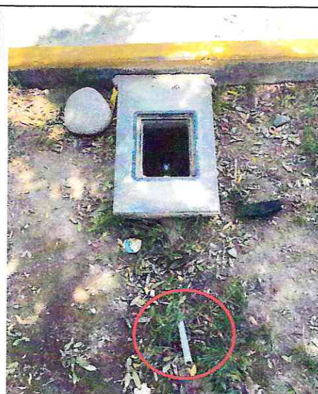
Imagen n° 30: Caja de concreto de agua sin tapa y con tubería expuesta.
