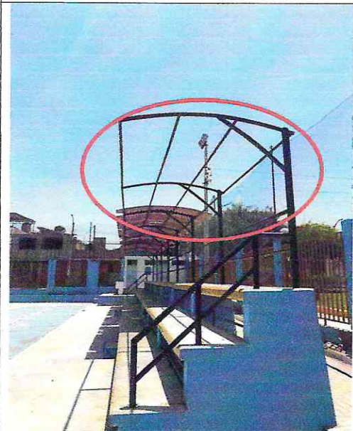
Imagen n° 184: Sin cobertura liviana en graderías de losa deportiva.
