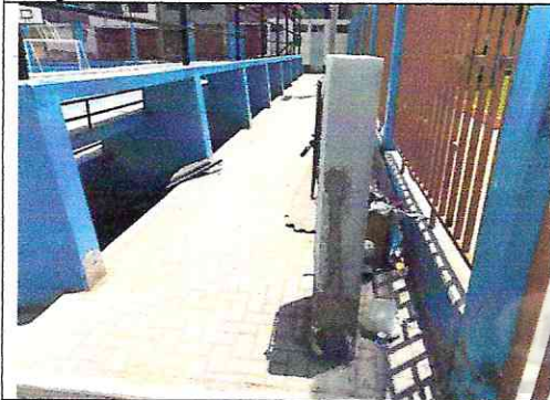
Imagen n° 182: Presencia de basura.
