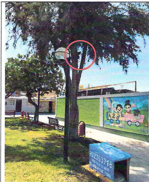
Imagen n° 136: Poste de luz sin farola y sin luminaria.
