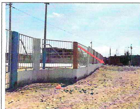
Imagen n° 15: Cerco perimétrico se encuentra inclinado con riesgo de colapso.
