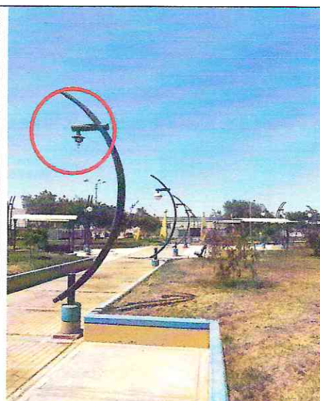
Imagen n° 24: Postes de luz sin farolas, con luminarias rotas.
