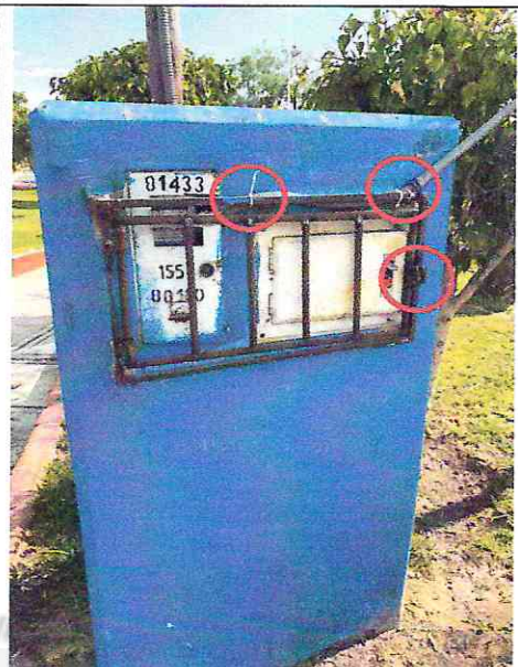
Imagen n° 66: Cable de ingreso al medidor de luz está sujetado por medio de cables y cintillos, la rejilla metálica del muro que contiene el medidor de luz no tiene candado.
