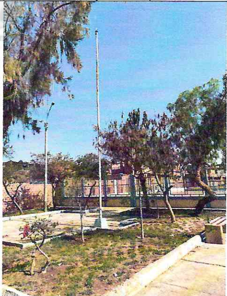
Imagen n° 83: Asta de la bandera se encuentra oxidado y despintado.
