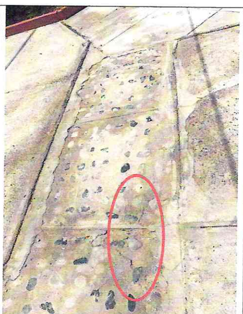
Imagen n° 151: Veredas de concreto con grietas y desgaste en su superficie.
