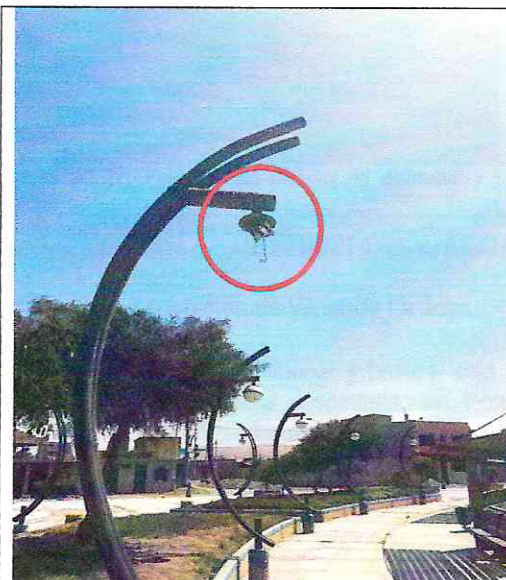
Imagen n° 23: Postes de luz sin farolas, con luminarias rotas.
