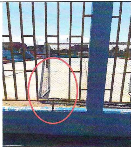
Imagen n° 34: Reja metálica de cerco perimétrico rota.
