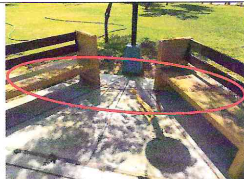
Imagen n° 55: Respaldares de bancas de madera con cables.
