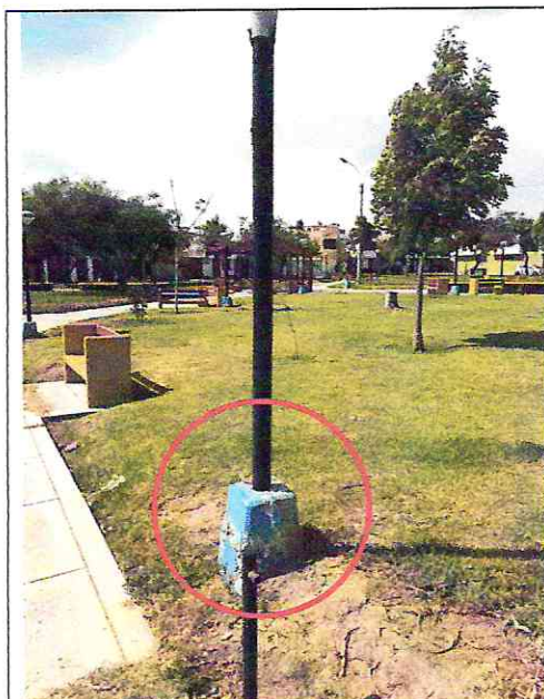
Imagen n° 51: Base de concreto de poste de luz despintado.
