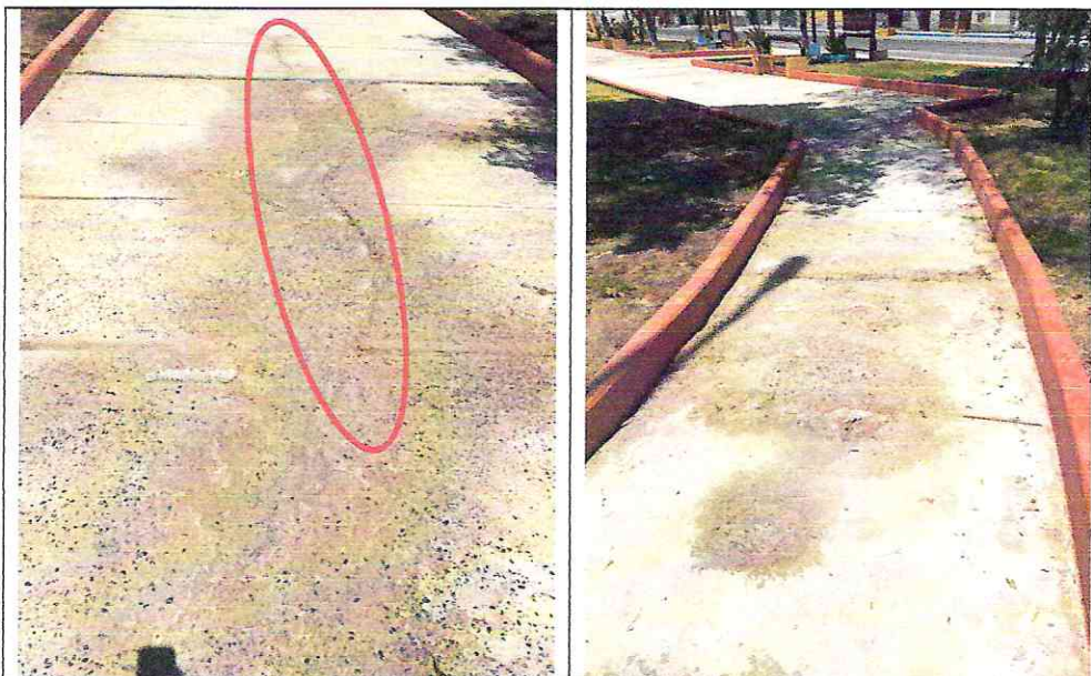
Imagen n° 152: Veredas de concreto con grietas y desgaste en la superficie.
