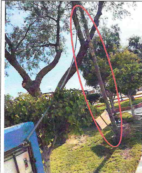
Imagen n° 65: Acometida eléctrica esta soportada por un poste de madera el cual es endeble y esta inclinado.
