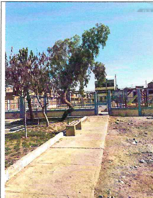
Imagen n° 78: Veredas de concreto en mal estado, jardineras de concreto y bancas despintadas.
