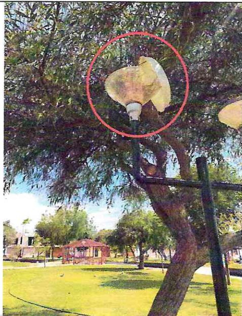
Imagen n° 48: Poste de luz con farola rota.
