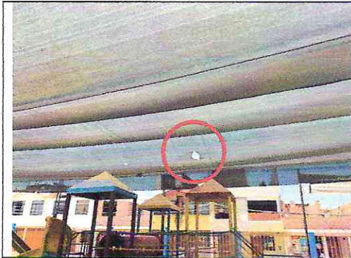
Imagen n° 180: Cobertura con malla Raschell rota.
