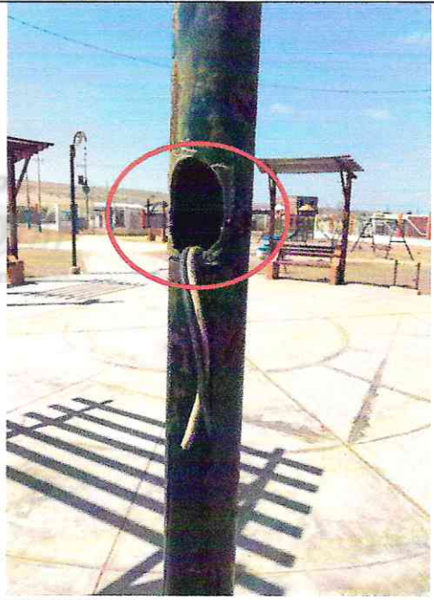
Imagen n° 20: Postes de luz sin tapas de registro con cables expuestos generando riesgo eléctrico a los vecinos.
