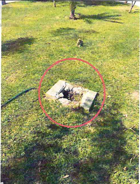
Imagen n° 50: Caja de concreto de agua en mal estado y sin tapa.
