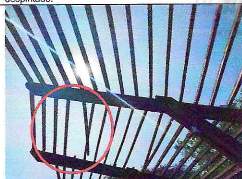
Imagen n° 53: Pérgola de madera rota.
