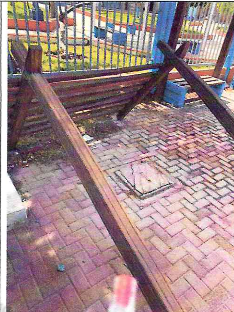
Imagen n° 121: Pérgola de madera rota.
