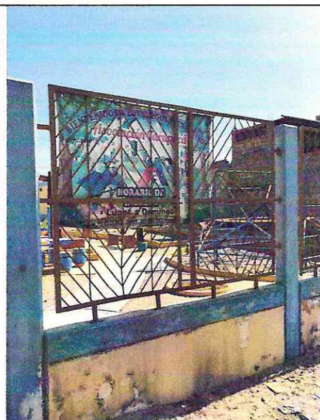
Imagen n° 85: Rejas metálicas del cerco perimétrico se encuentran oxidadas y despintadas.
