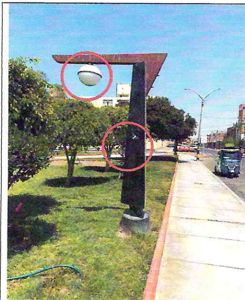
Imagen n° 140: Poste de luz con farola rota y sin tapa de caja de registro con cables expuestos.
