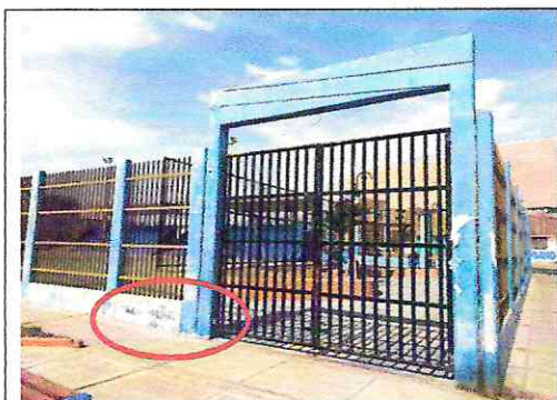
Imagen n° 61: Fachada y cerco perimétrico de la losa deportiva con pintas (grafitis) y despintada.
