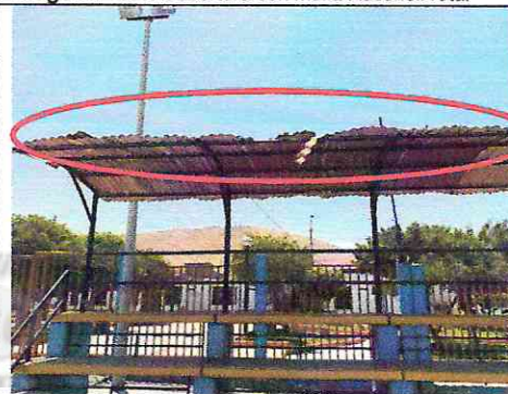
Imagen n° 183: Cobertura liviana en graderías de losa deportiva rota.
