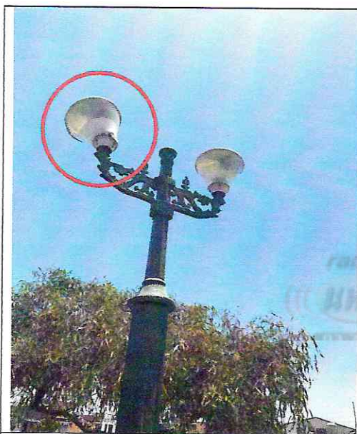
Imagen n° 39: Farola de poste de luz rota.
