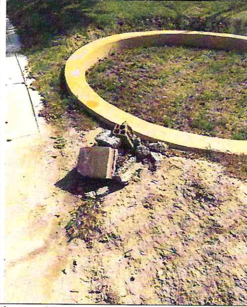
Imagen n° 90: Presencia de desmonte y basura.
