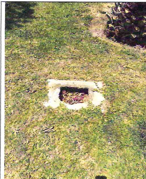
Imagen n° 160: Caja de concreto de agua sin tapa.
