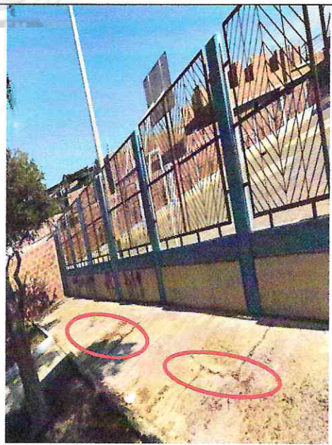
Imagen n° 79: Veredas de concreto en mal estado y presencia de grietas.
