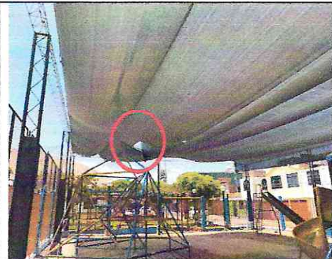
Imagen n° 181: Cobertura con malla Raschell rota.
