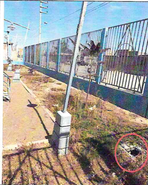
Imagen n° 11: Caja de concreto de agua sin tapa.
