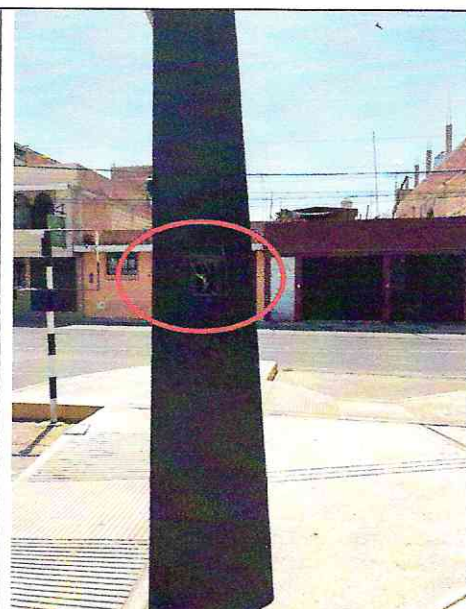
Imagen n° 141: Poste de luz con farola rota y sin tapa de caja de registro con cables expuestos.
