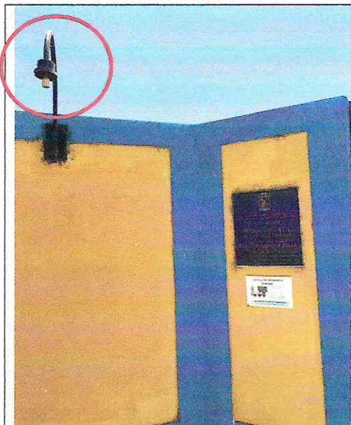
Imagen n° 106: Muros del cerco perimétrico sin luminarias.
