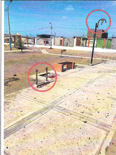
Imagen n° 19: No hay tachos de basura, postes de luz sin farolas, con luminarias rotas.
