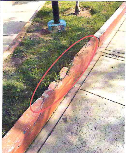
Imagen n° 67: Jardineras de concreto rotas y despintadas.
