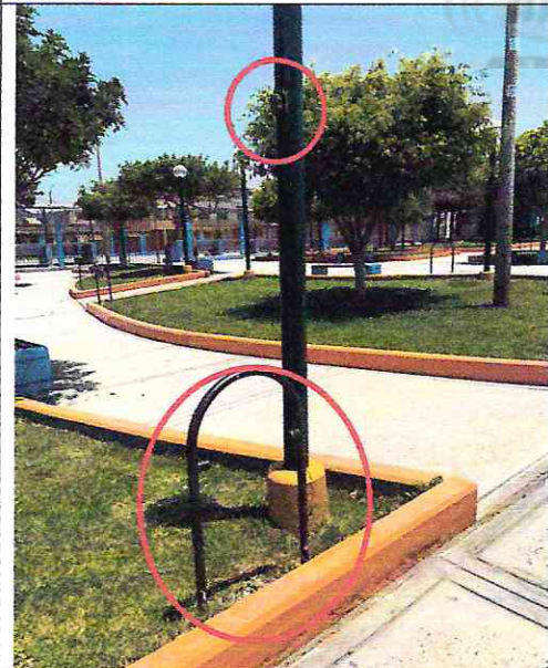
Imagen n° 174: Caja de registro rota con cables expuestos y sin tacho de basura.
