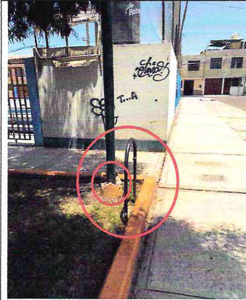
Imagen n° 172: Pintas en muros de cerco perimétrico (grafiti), sin tacho de basura y base de concreto de poste de luz roto.
