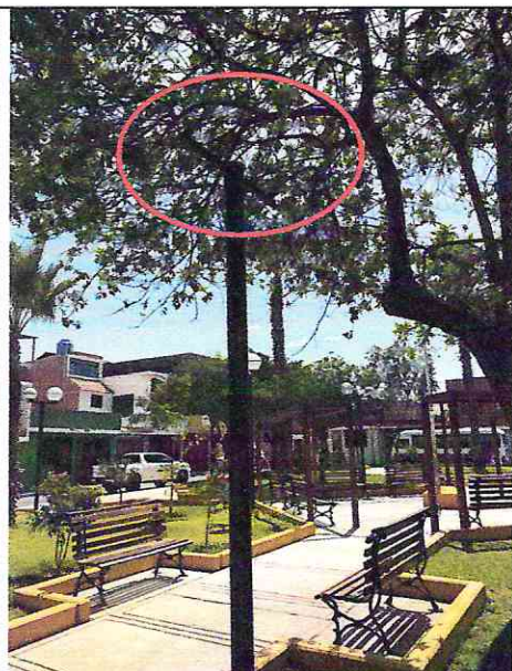
Imagen n° 137: Poste de luz sin farolas y sin luminarias.
