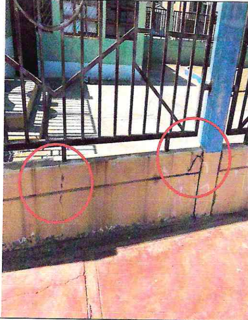
Imagen n° 7: Grietas en cerco perimétrico.
