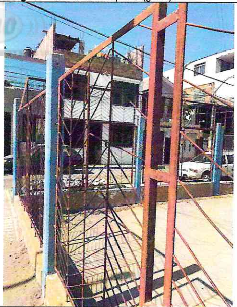
Imagen n° 103: Malla metálica de cerco perimétrico rota y oxidada.
