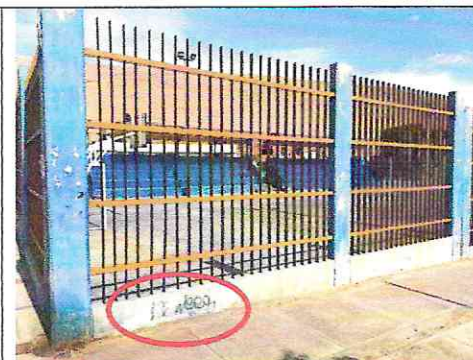
Imagen n° 62: Cerco perimétrico de la losa deportiva con pintas (grafitis) y despintado.
