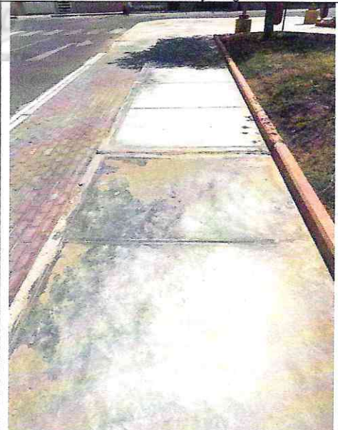
Imagen n° 115: Veredas de concreto con fisuras y desgaste.
