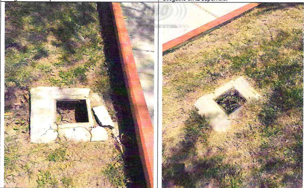
Imagen n° 154: Caja de concreto de agua en mal estado y sin tapa.
