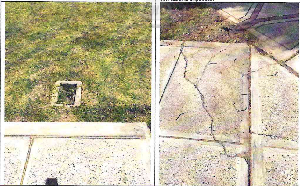
Imagen n° 110: Caja de concreto de agua sin tapa.
