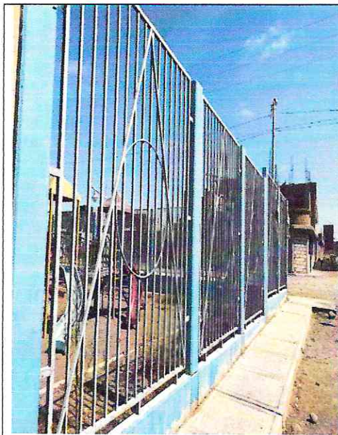
Imagen n° 13: Cerco perimétrico despintado en rejas metálicas y elementos de concreto.
