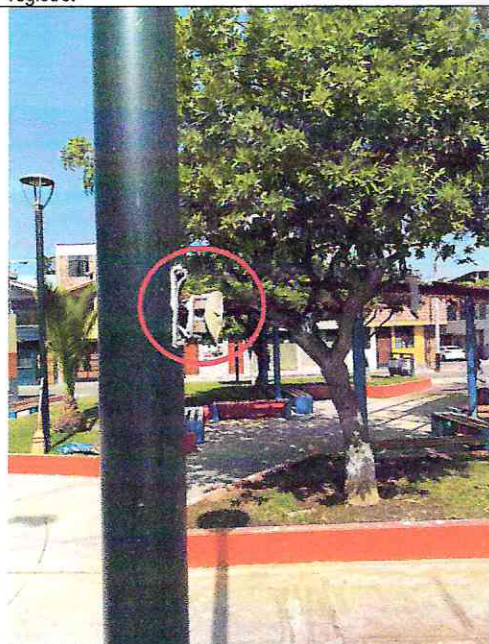
Imagen n° 94: Poste de luz sin tapa de registro.
