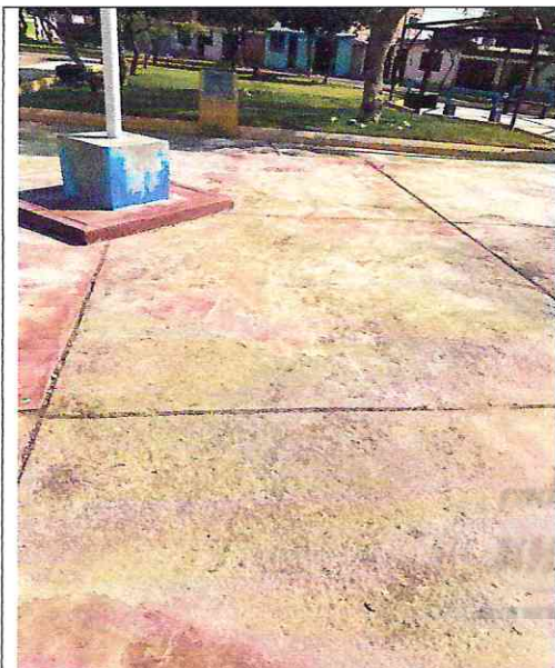
Imagen n° 57: Piso de concreto pulido coloreado de zona cívica con desgaste y fisuras.
