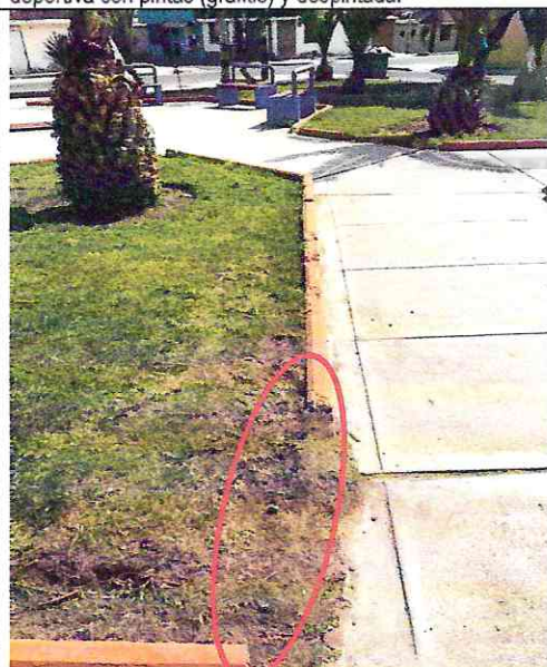
Imagen n° 63: Jardineras de concreto rotas.
