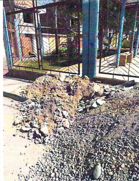
Imagen n° 105: Presencia de material de desmonte y basura.
