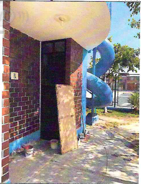
Imagen n° 91: Presencia de basura.
