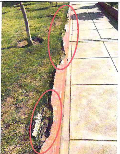
Imagen n° 68: Jardineras de concreto rotas y despintadas.
