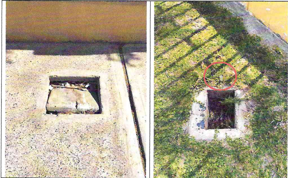
Imagen n° 108: Caja de concreto de agua con tapa rota.
