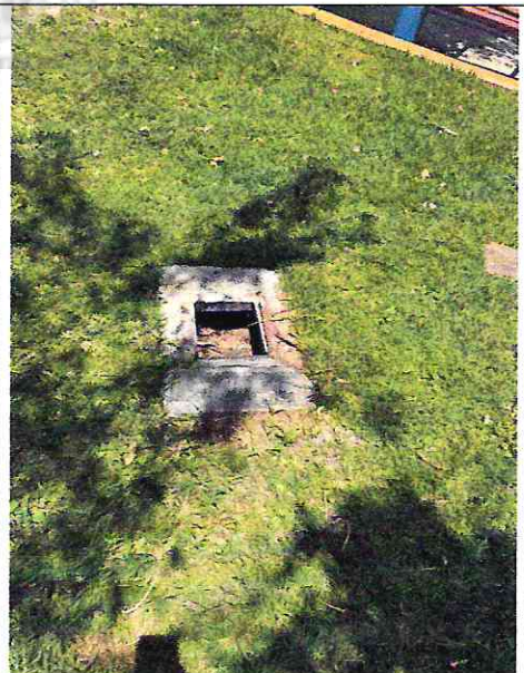
Imagen n° 175: Caja de concreto de agua sin tapa.
