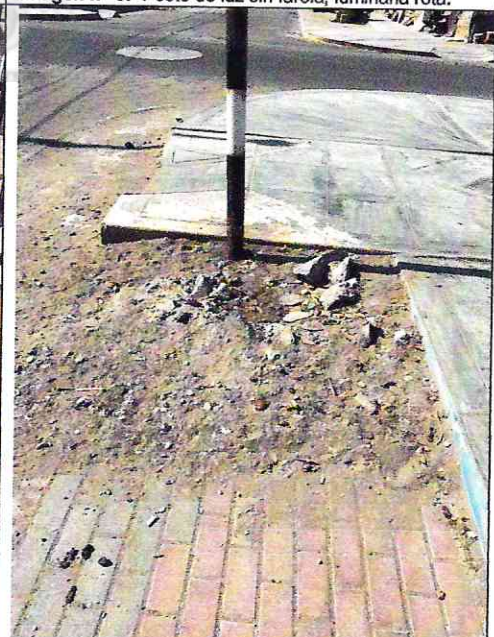
Imagen n° 8: Presencia de material de desmonte y basura.
