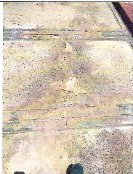
Imagen n° 165: Veredas de concreto con grietas y desgaste en su superficie.
