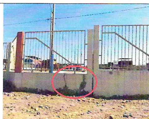
Imagen n° 16: Grietas del cerco perimétrico vienen desde la cimentación.
