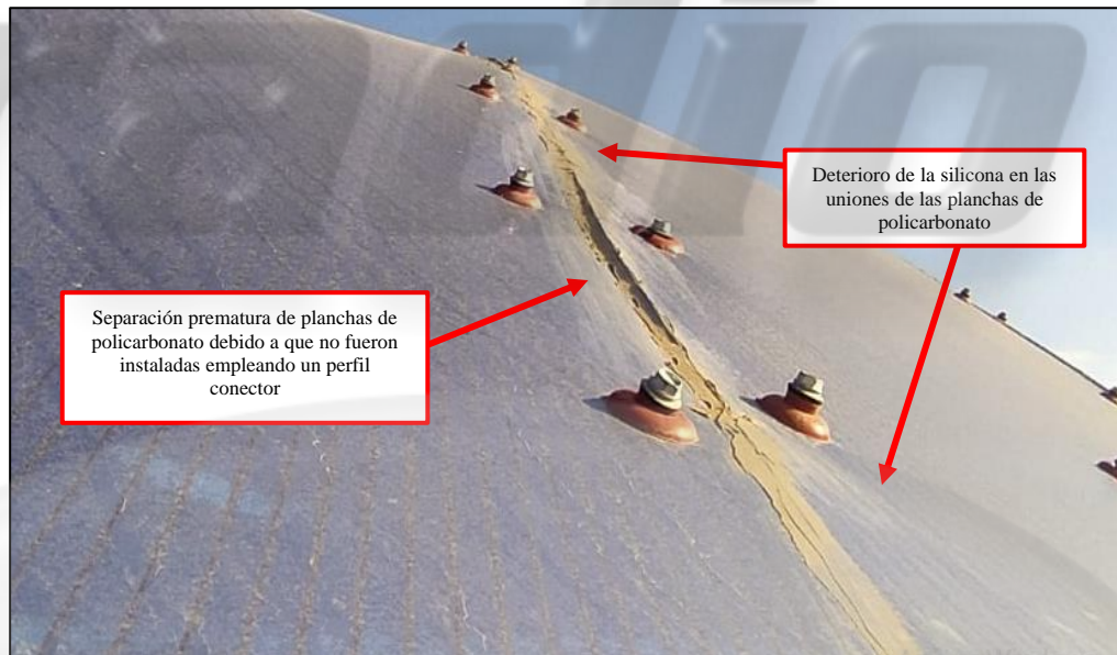
Imagen n.º 8 Deficiencias constructivas en las uniones de la claraboya tipo 1
