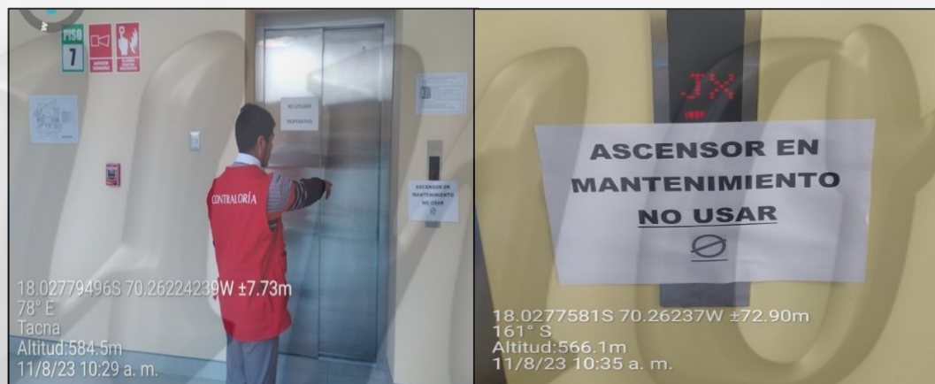
Imagen n.º 10 y 11 Ascensor n.º 04 no se encuentra en funcionamiento (séptimo piso)
