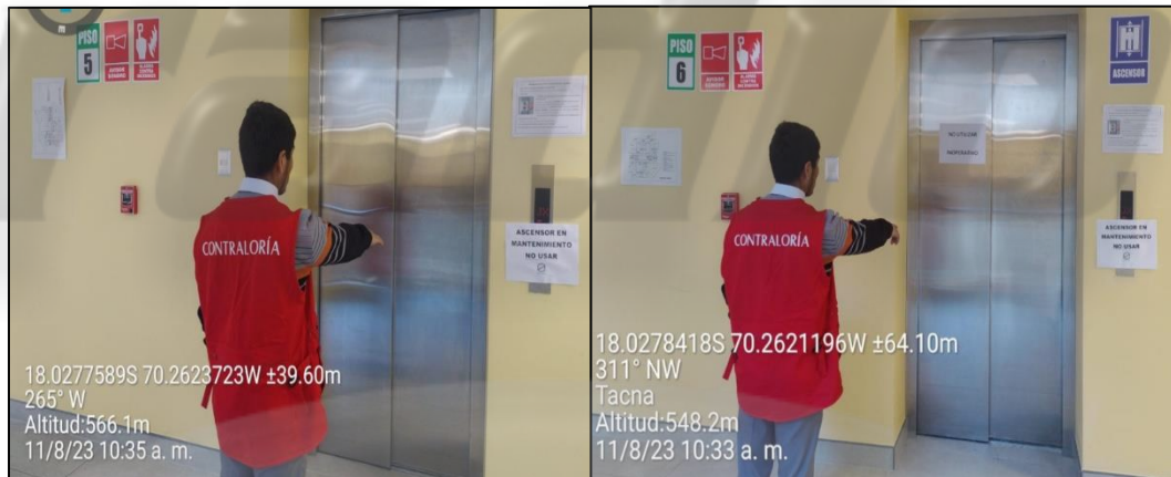
Imagen n.º 8 y 9 Ascensor n.º 04 no se encuentra en funcionamiento (quinto y séptimo piso)
