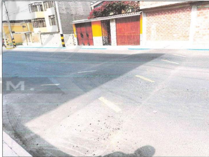
IMAGEN N° 9 REDUCTOR DE VELOCIDAD TIPO RESALTO EN PROGRESIVA 1+300
