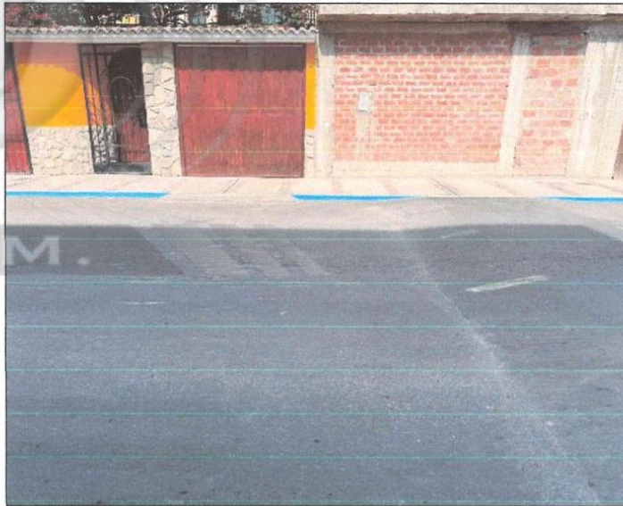
IMAGEN N° 11 DESPRENDIMIENTOS GENERADOS EN ZONA POSTERIOR A RESALTO VEHICULAR
