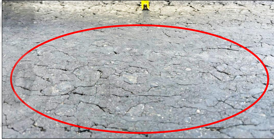
IMAGEN N° 3 FISURAS DEL TIPO PIEL DE COCODRILO SOBRE CARPETA ASFÁLTICA
