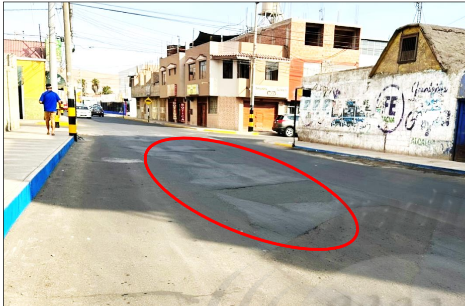
IMAGEN N° 4 EXUDACIÓN (BROTE) DE ASFALTO RC-250, SOBRE CARPETA ASFÁLTICA
