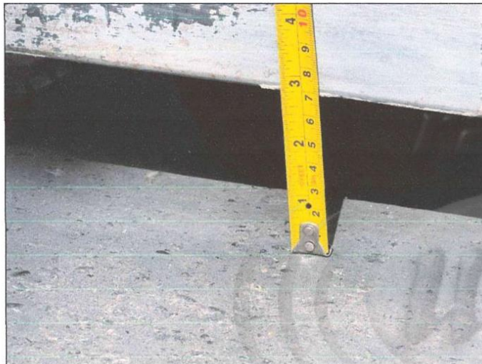
IMAGEN N° 6 IRREGULARIDAD SUPERFICIAL DE 70 mm, MEDIDA SOBRE CARPETA ASFÁLTICA CONFORMADA
