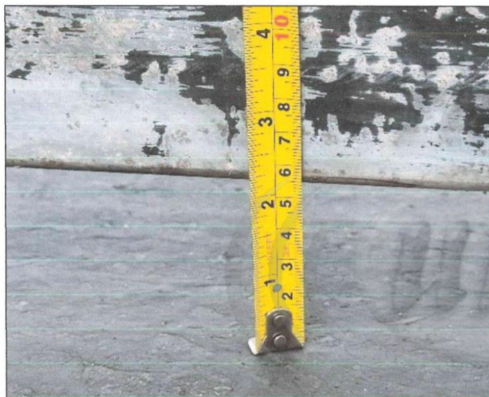
IMAGEN N° 8 DESNIVEL DE 55 mm, SOBRE CARPETA ASFÁLTICA CONFORMADA
