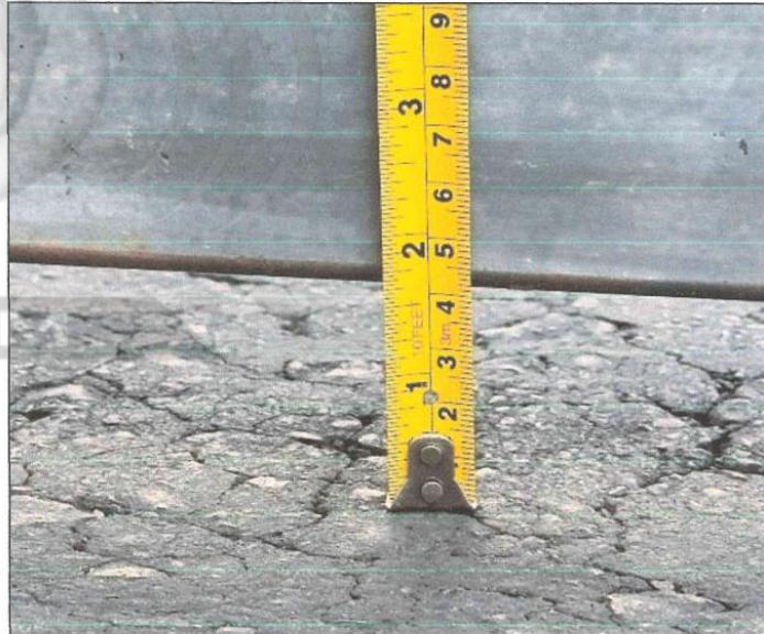
IMAGEN N° 7 DESNIVEL DE 42 mm, SOBRE CARPETA ASFÁLTICA CONFORMADA
