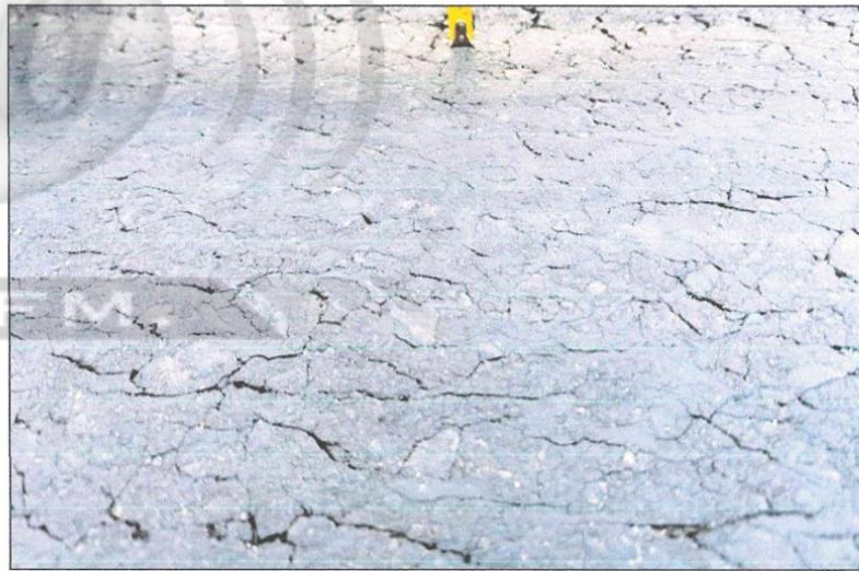
IMAGEN N° 3 FISURAS DEL TIPO PIEL DE COCODRILO SOBRE CARPETA ASFÁLTICA
