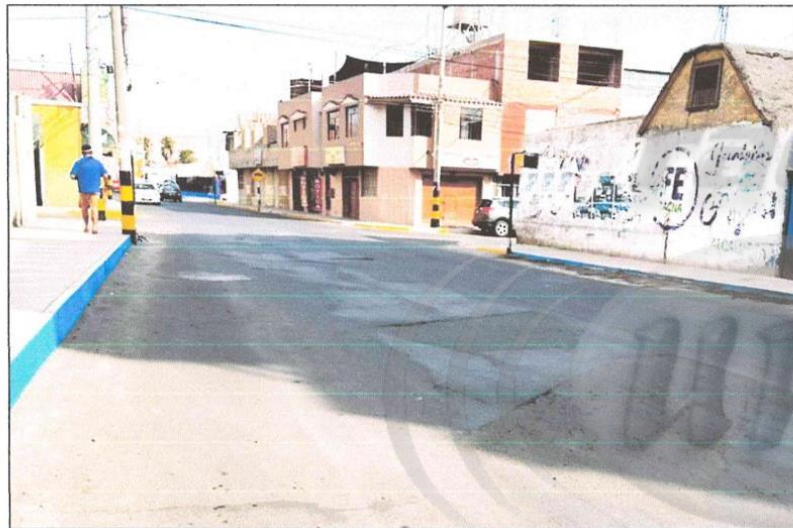
IMAGEN N° 4 EXUDACIÓN DE ASFALTO RC-250, SOBRE CARPETA ASFÁLTICA
