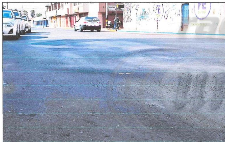
Fuente: Visita de inspección realizada el 10 de abril de 2024.
