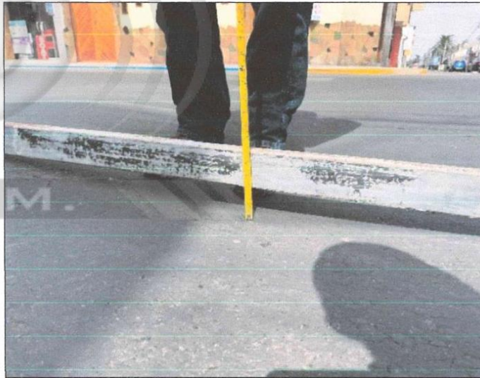
IMAGEN N° 5 TENDIDO DE REGLA METÁLICA SOBRE CARPETA ASFÁLTICA CONFORMADA, PARA MEDICIÓN DE DESNIVELES
