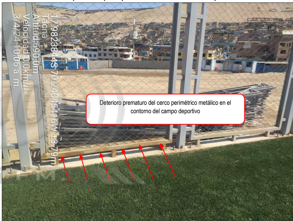
Imagen n.º 12. Deterioro prematuro por la presencia de corrosión en cerco perimétrico
