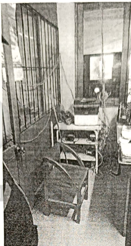
FOTO N°12 Se observa cableado expuesto y hacinado, así como presencia de cables mellizos.
