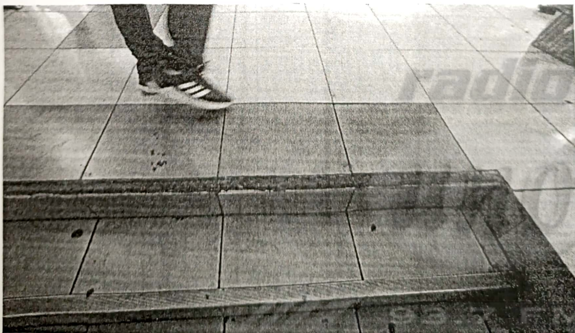
FOTO N°17 Se observa gradas con perfiles de seguridad faltantes.
