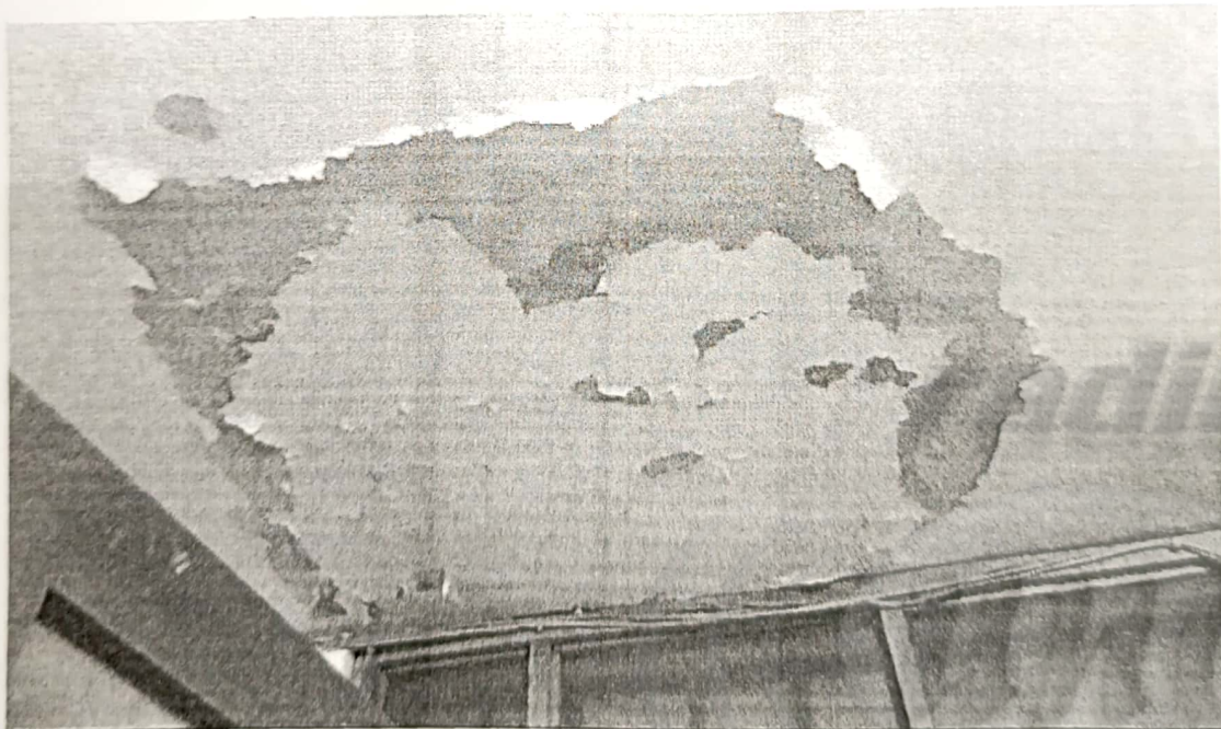
FOTO N°11 - Fisuras superficiales y grietas en techos, así como presencia de humedad y desprendimiento de pintura.
