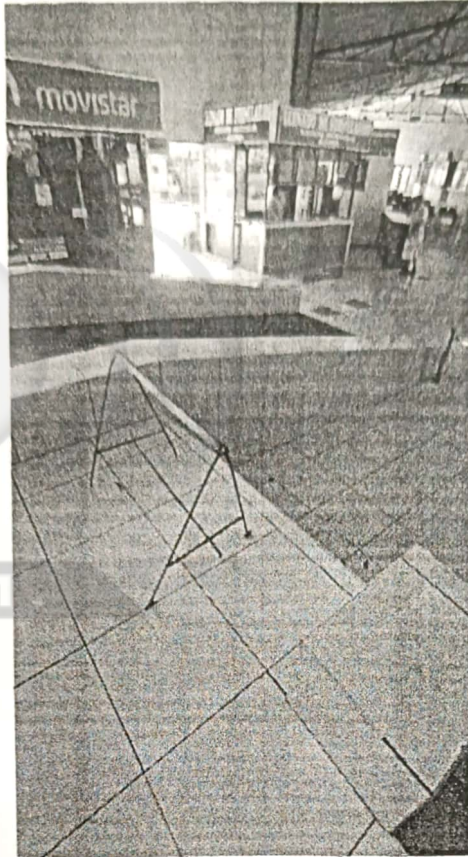
FOTO N°18 Cambios de nivel no transitables con elementos metálicos móviles, se requiere fijos para impedir el tránsito y evitar accidentes.
