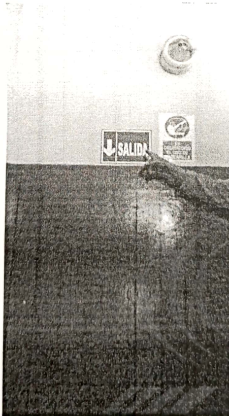
FOTO N°10 Se observa señalización incorrecta de evacuación en escalera..
