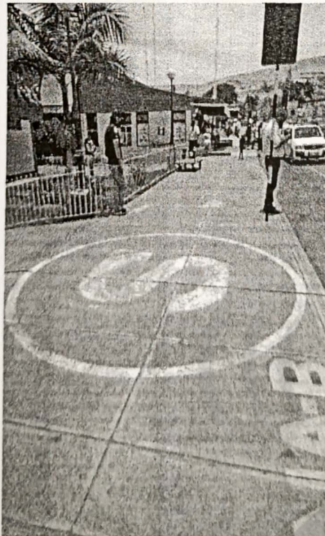
FOTO N°02 Se observa señalización de zona segura con desgaste de pintura.
