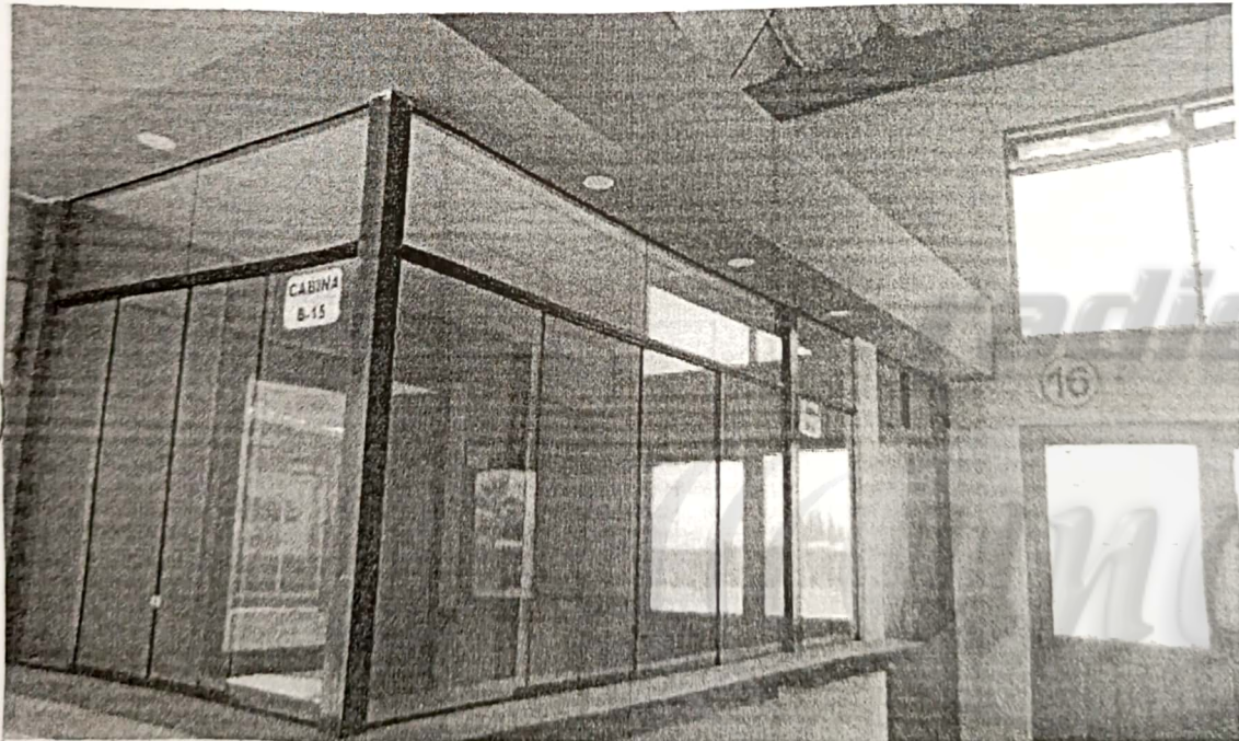
FOTO N°21 Se observan vidrios separadores sin laminas ni cintas de seguridad.
