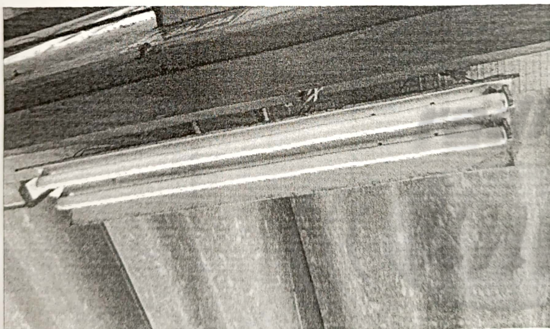
FOTO N°13 Se observa luminaria sin cintillo de seguridad.
