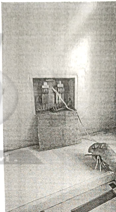
FOTO N°16 Tableros eléctricos no cuentan con señalización, ni leyenda, además de ser de madera y presencia de cables mellizos expuestos, todo ello no concordante con la NTP EM.010 Instalaciones eléctricas interiores.
