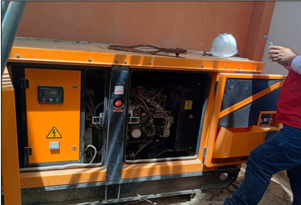
Imagen N° 2 Verificación del Grupo Electrónico
