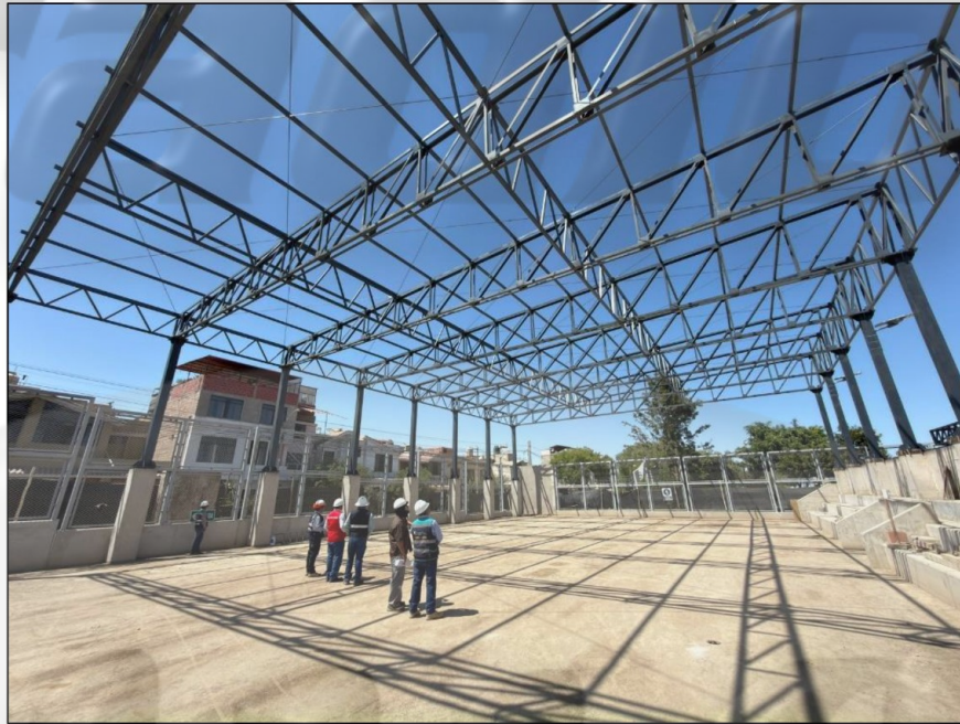
Imagen n.º 5 Cancha de usos múltiples – Estructura metálica sobre la que se instalará cobertura de aluzinc
