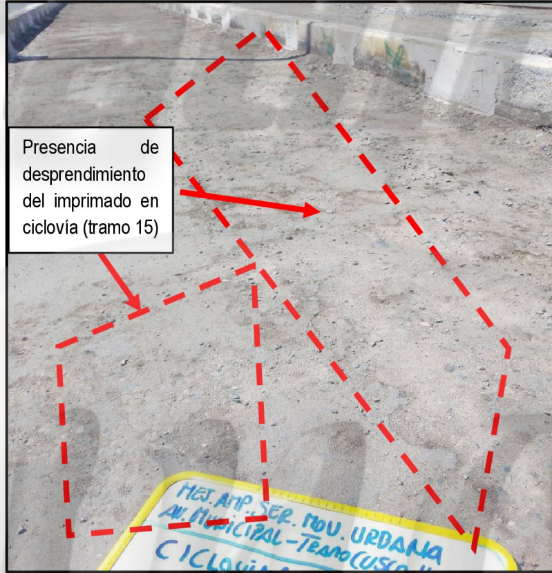
Fotografía n.º 5 Deterioro del Imprimado en tramo 15 de la Ciclovía
