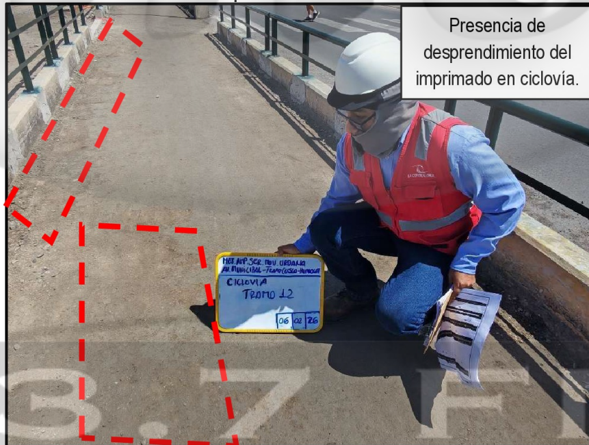
Fotografía n.º 6 Deterioro del Imprimado en tramo 12 de la Ciclovía
