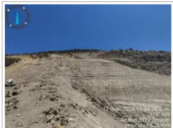
Fotografía n.º 6: Vista de estado actual a nivel de excavación de estribo derecho de la presa.
