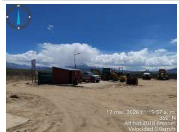
Fotografía n.º 4: Vista de taller de mantenimiento y equipos (retroexcavadora, camion cisterna y motoniveladora) en el campamento del Contratista.
