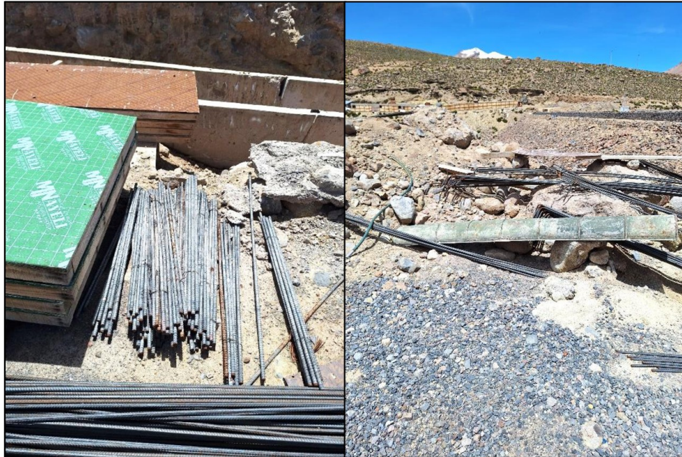
Fuente: Acta de visita a obra n.° 001-2026-OCI3413-SCC de 25 de febrero de 2026. Elaborado por: Comisión de Control Concurrente
