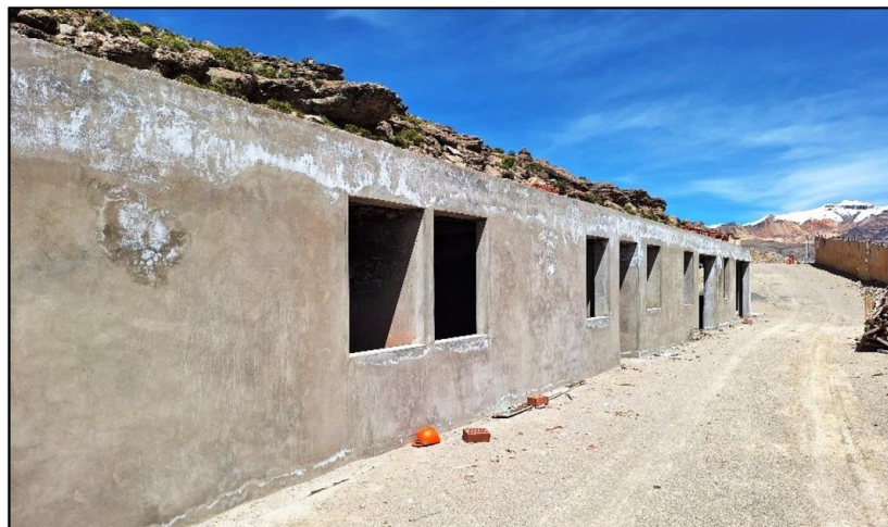
IMAGEN N° 13 EFLORESCENCIA SALINA EN TARRAJEO DE MUROS EXTERIORES
