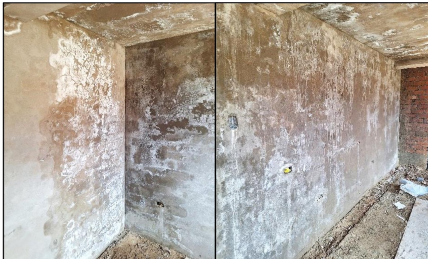
IMÁGENES N° 14 Y 15 EFLORESCENCIA SALINA EN TARRAJEO DE MUROS INTERIORES
