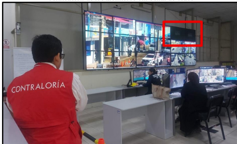
Imagen n.º 01 Verificación de los Monitores sin Señal de Video
