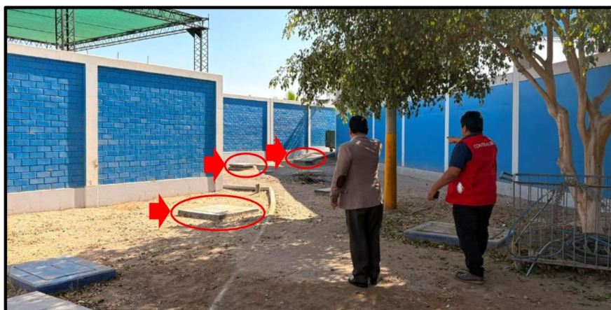
FOTOGRAFÍA N° 6 UBICACIÓN DEL SILO O POZO SÉPTICO SIN PROTECCIÓN PERIMETRAL
