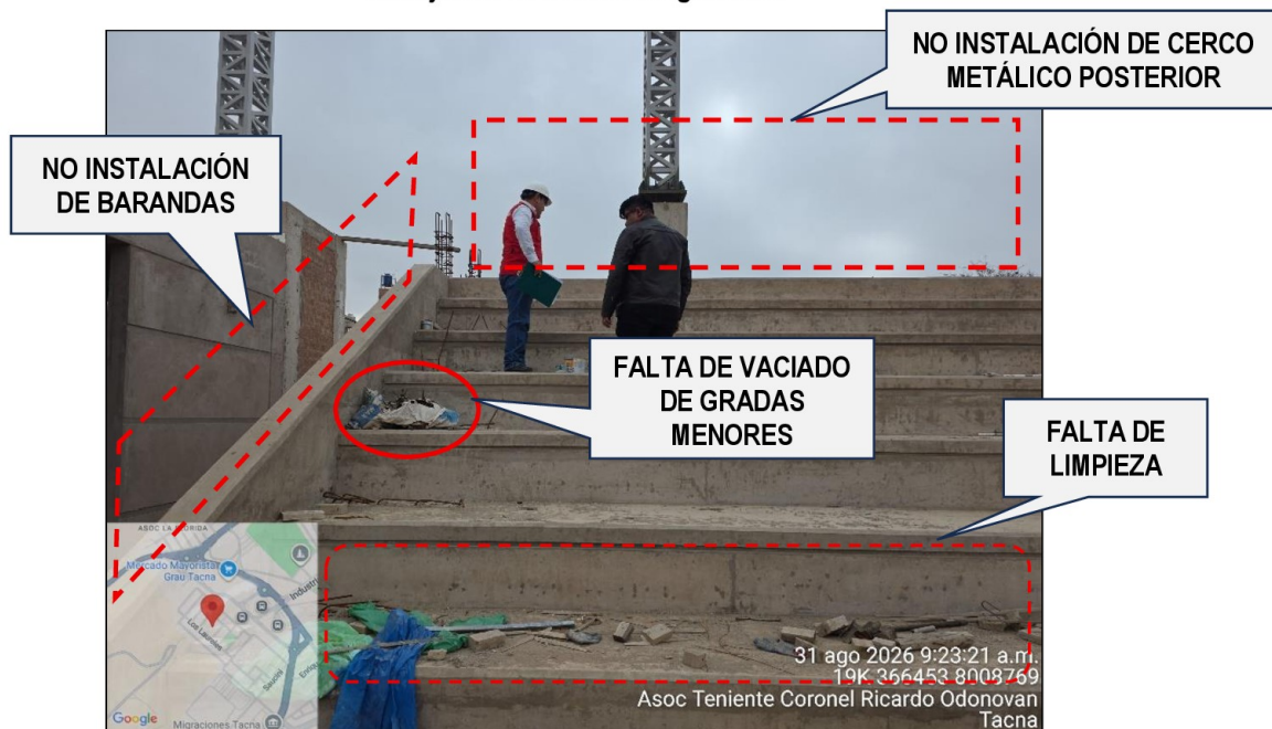
Imagen n.º 14 Trabajos no concluidos en graderías
