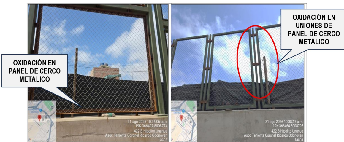
Imágenes n.ºs 8 y 9 Oxidación en cerco metálico y uniones
