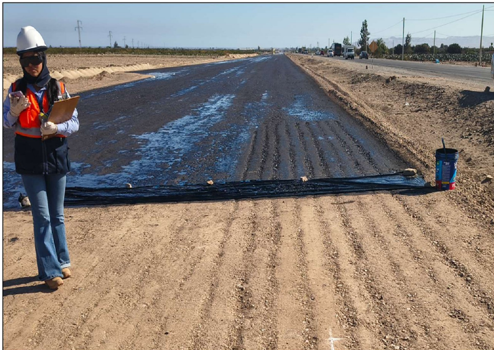
Imagen n.º 5. Superficie no uniforme de la base granular con imprimación asfáltica en progresiva km 30+820
