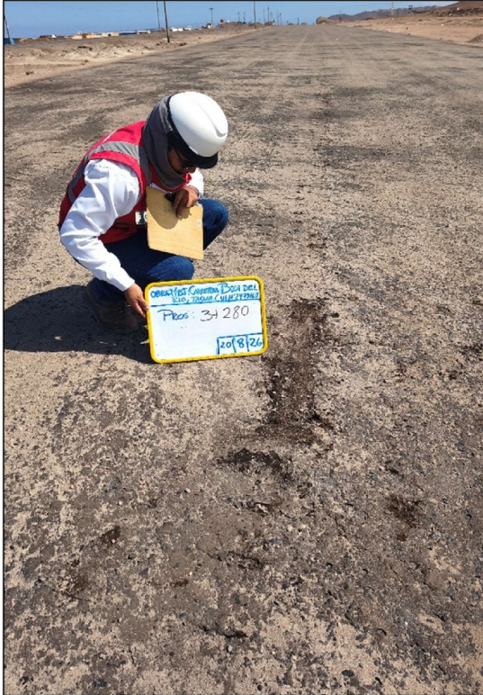
Imagen n.º 8. Desprendimiento del Imprimado en la progresía KM 3+280
