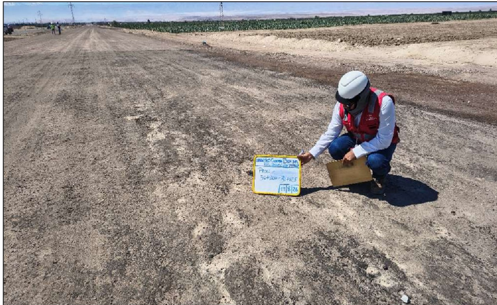
Imagen n.º 4. Superficie no uniforme de la base granular con imprimación asfáltica en progresiva km 30+800 al 30+805
