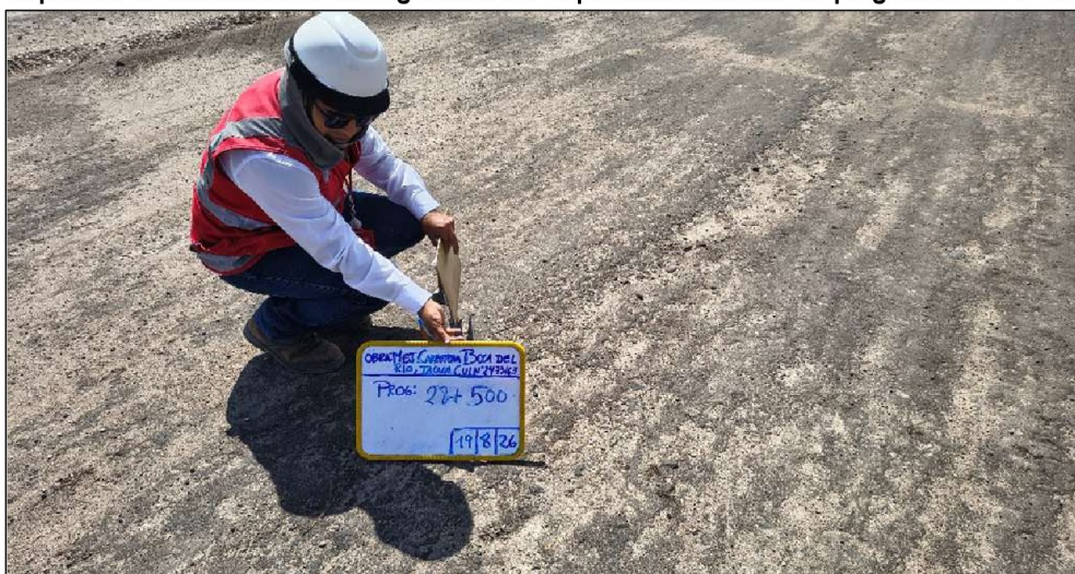
Superficie no uniforme de la base granular con imprimación asfáltica en progresiva km 28+500
