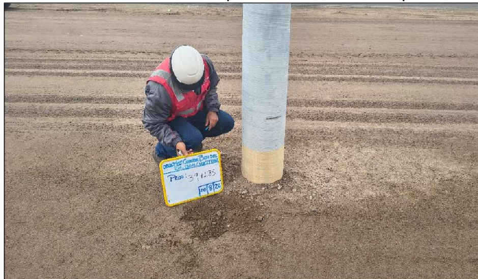
Imagen n.º 2. Zona de subbase alrededor de los postes no está debidamente compactada
