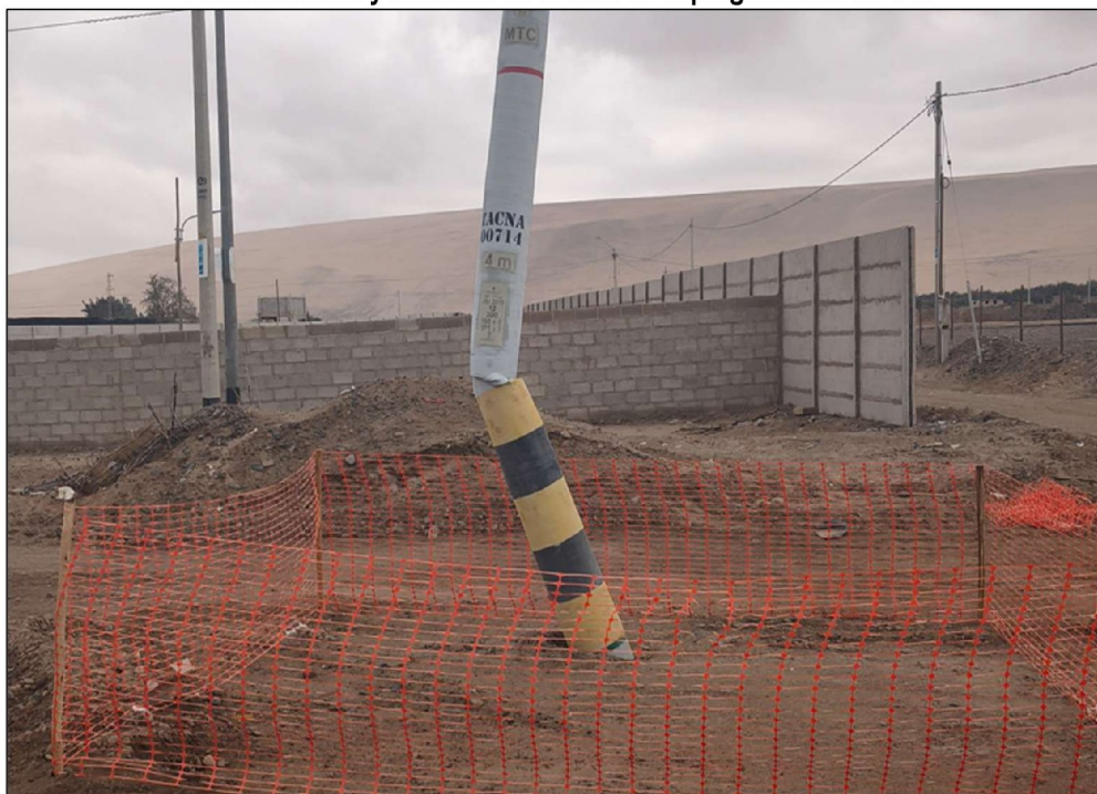
Imagen n.º 1. Poste inclinado y con daño en la base en la progresía KM 38+340
