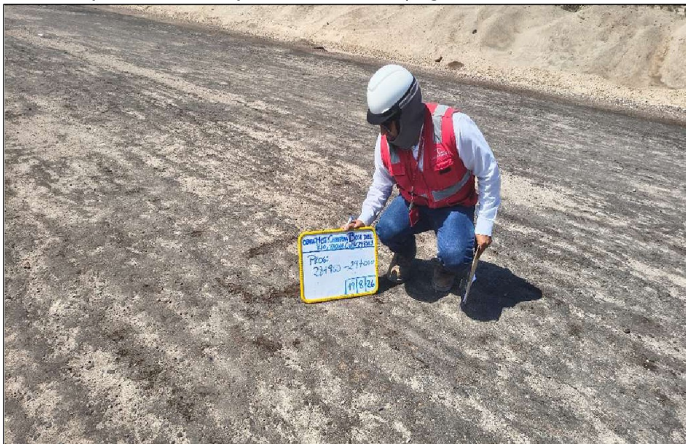
Imagen n.º 10. Desprendimiento del imprimado de la vía en la progresía km 28+960 al 29+000
